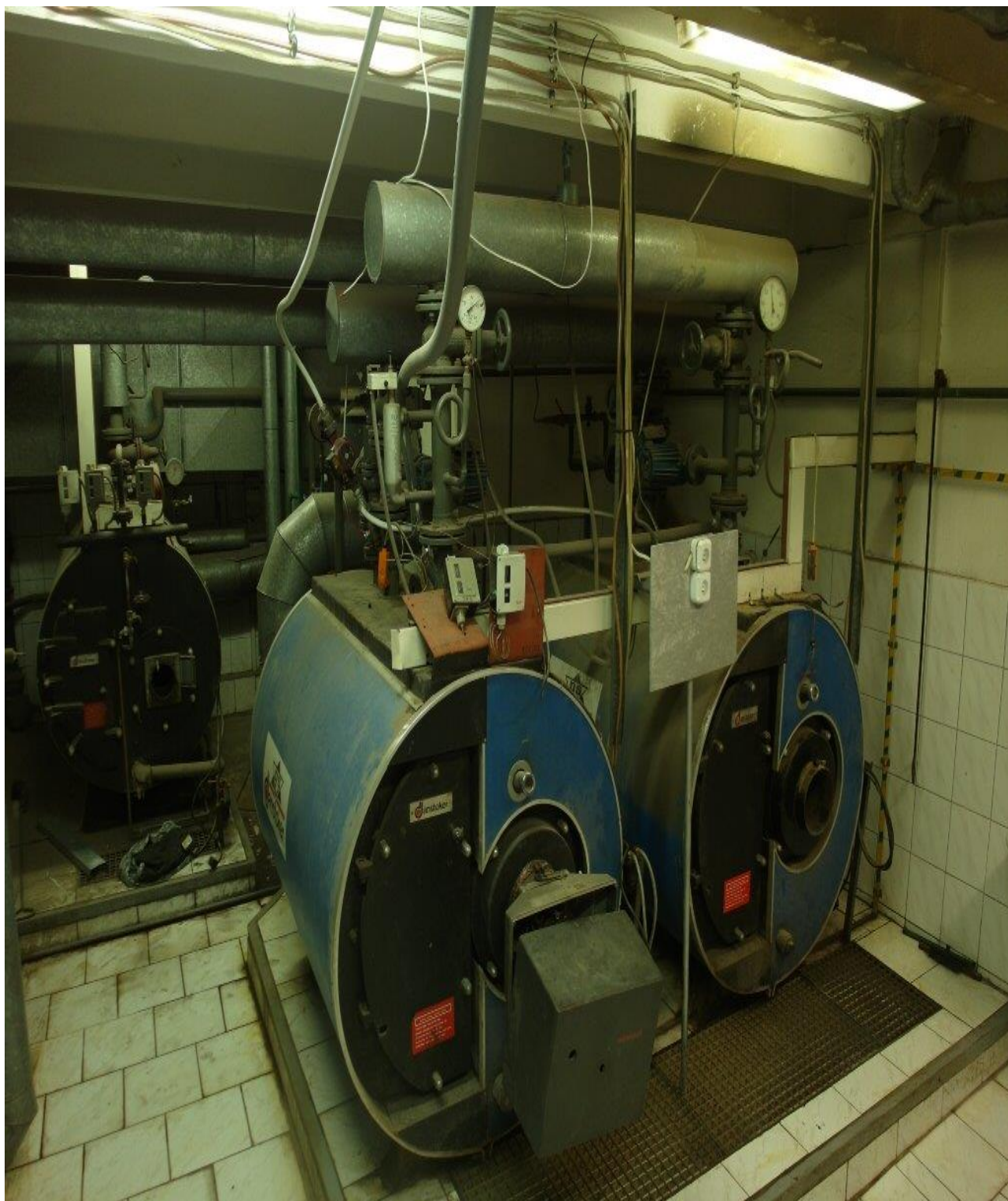
Fot. 1. Widok na istniejące kotły. Z frontu wodne, a z tyłu kocioł parowy.
